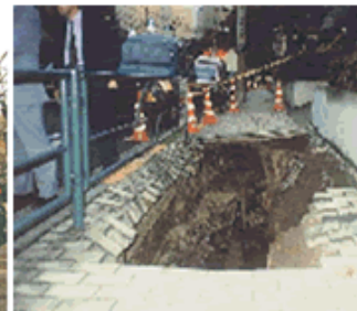
道路陥没状況
