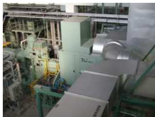
施工後：起動信頼性の高いガスタービンエンジンに取替 維持管理の高度化の事例（雨水ポンプ）
