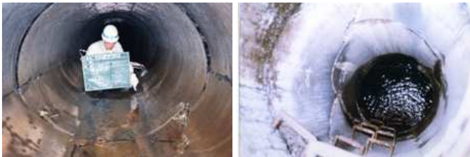
阪神・淡路大震災による下水道施設の被災状況
