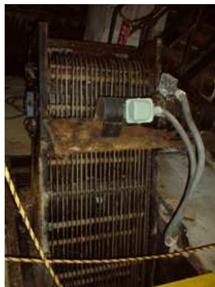
浄化センターのスクリーンの劣化状況
