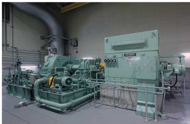
■蒸気タービン発電機■（東部総合処理センター）
