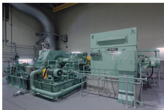
蒸気タービン発電機（東部総合処理センター）
