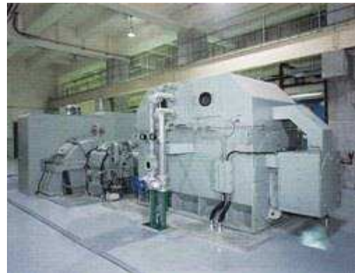
蒸気タービン発電機
