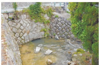
▲仁川の川底をくぐった先の出口部分の様子(百間樋児童遊園南側)
