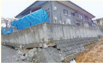
▲地震の影響で擁壁が崩れ、傾いた家
