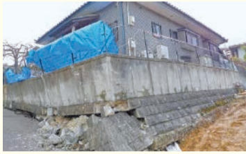
▲地震の影響で擁壁が崩れ、傾いた家
