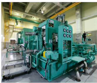
蒸気タービン発電機
