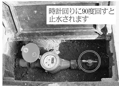
止水栓 (戸建住宅)
