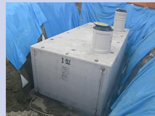
（耐震性防火水槽）
