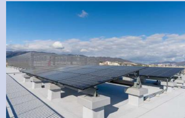
（太陽光発電設備）
