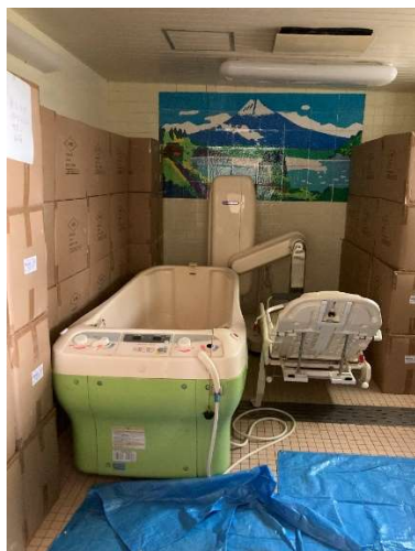
<旧特殊浴室にある入浴装置>
