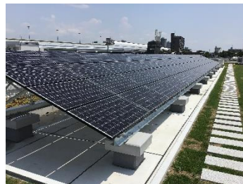
図 1-6 香榎園小学校の太陽光発電設備
