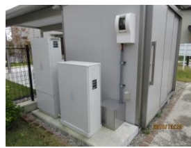
↑備蓄倉庫・蓄電池
