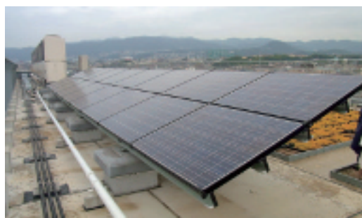
屋上を利用した太陽光発電(高木小学校)
