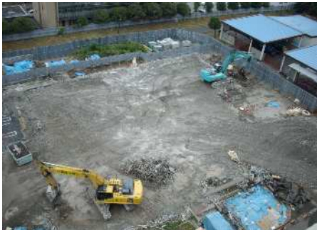
地上部分の解体がほぼ終了しました。引き続き地中部分の基礎などを撤去します。
