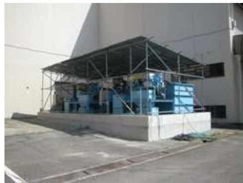
仮設水処理装置(除染水再利用)の設置
