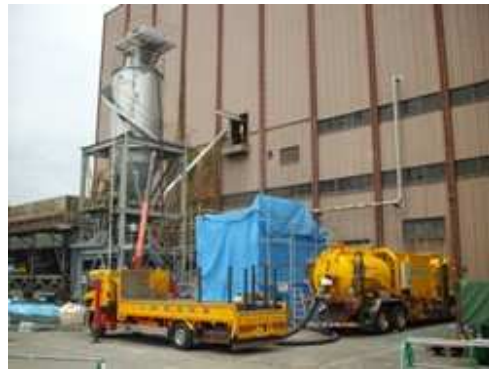
消石灰サイロからの消石灰抜き取り
