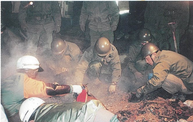
土砂崩れ現場では夜を徹して救出活動が続けられた （仁川百合野町）
