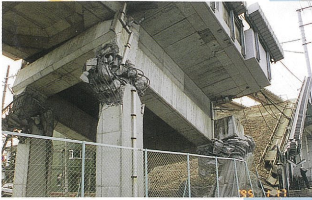
山陽新幹線高架の落下 (上田市 1 丁目)
