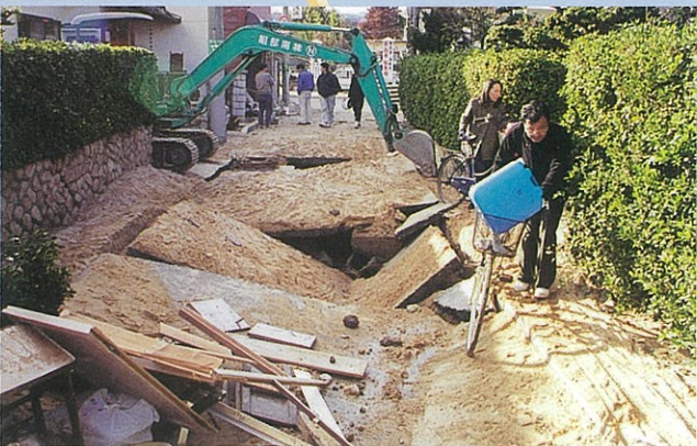
住宅街の暗渠が破壊され生活道路も使用不能となった (段上町 2 丁目)
