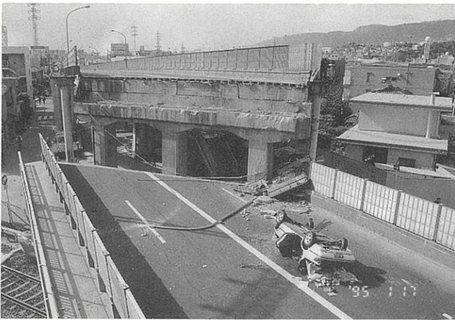
落橋した国道171号線 (野間町)
