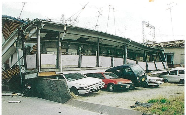
共同住宅の1階部分が壊れ駐車場の車両も破損 (青木町)
