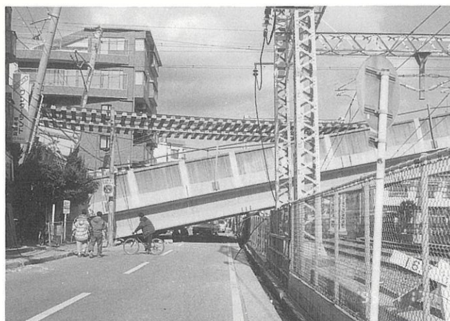
落橋した新幹線（松籟荘）
