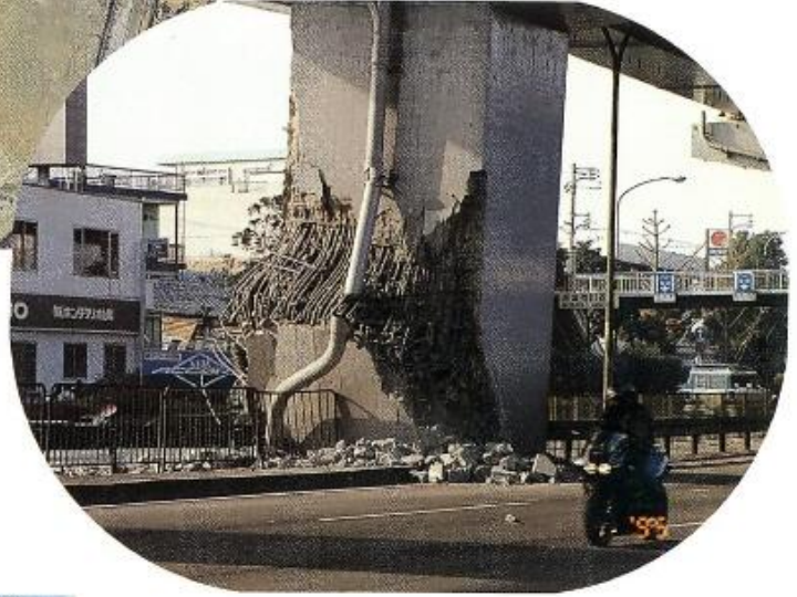
▲ 高速道路の橋脚部分も数多く損壊した。 (川西町)
