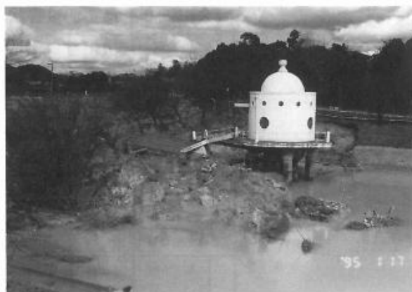
上・中・下3つの池の間の堤が崩壊したニテコ池貯水池
