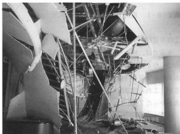
被災したフレンテホール。外観に比して内部の損傷がひどい。ホールロビーの天井部分が完全に落ちてしまっている。
