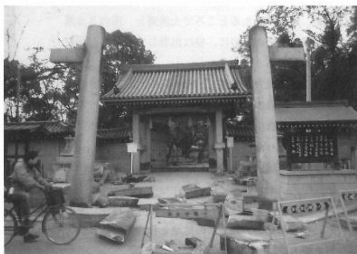
西宮神社の鳥居の崩落
