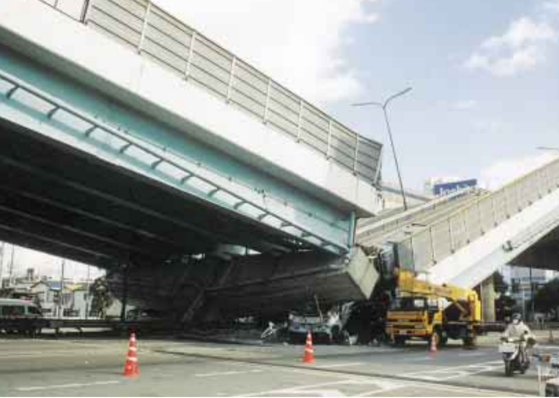
市内の3カ所で阪神高速道路が倒壊。 (神戸線 甲子園付近)
