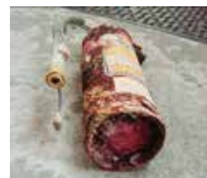
本体が錆びた消火器
