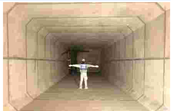
雨水貯留施設の整備（鳴尾駅前雨水調整池）
