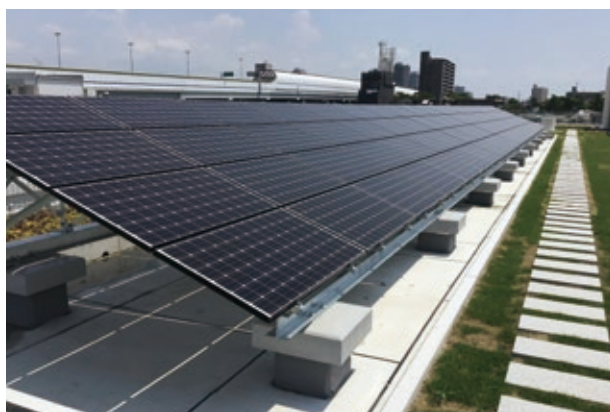
香榎園小学校の太陽光発電設備
