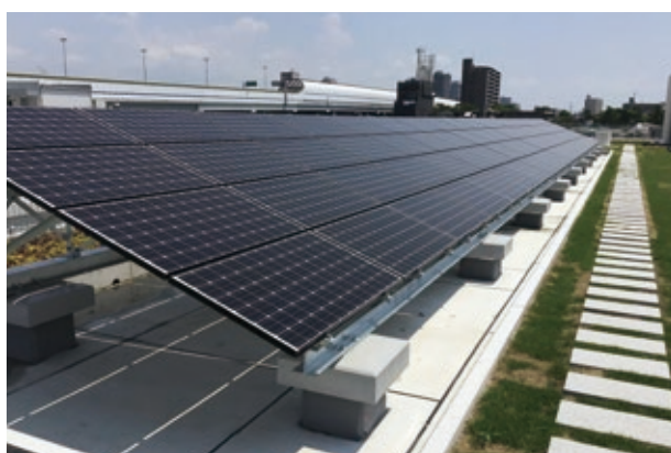
香櫨園小学校の太陽光発電設備
