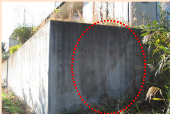
コーナー部でのひび割れ
