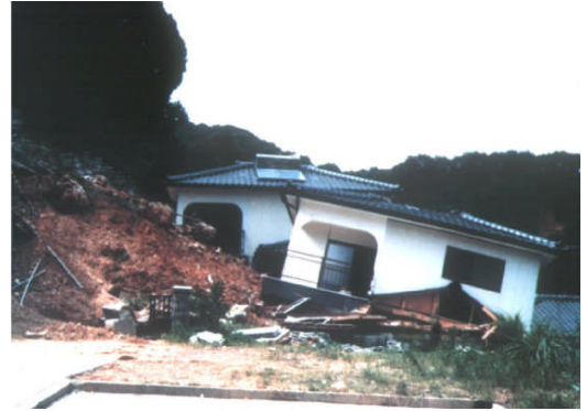
裏山のがけ崩れによる宅地被害
