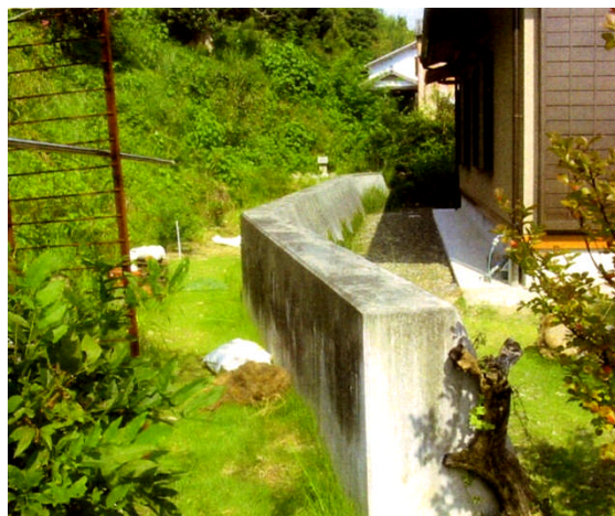
待ち受け擁壁の設置例
